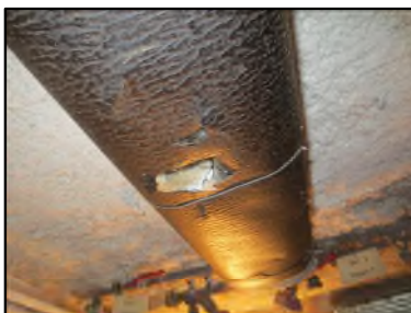
Photo N° 1247 ECH-N°1 CALORIFUGEAGE --COULOIRS DE CAVES -1 Conduits de fluide Laine minérale + enveloppe bituminée
